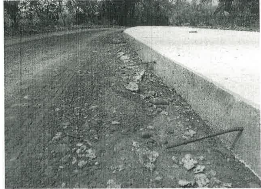
Concepto de obra ejecutado: Colocación de barra de amarre con varilla corrugada
