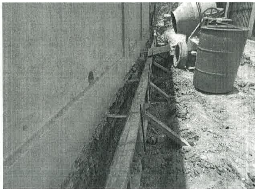
Concepto de obra ejecutado: Cimbrado para construcción de guarnición de concreto simple de sección 15 x 20 x 50 cm.
