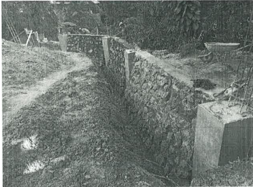
Concepto de obra ejecutado: Construcción de muro de contención a base de piedra braza
