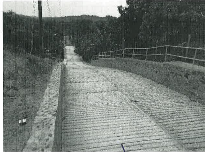
Concepto de obra ejecutado: Pavimento de concreto hidráulico de 18 CM de espesor f_c=250 \text{ Kg/cm}^2 acabado texturizado
