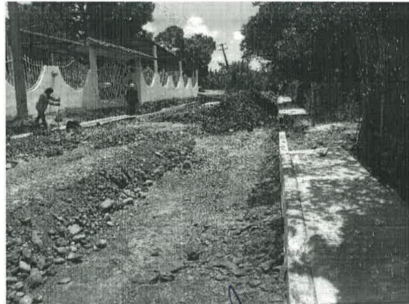
Concepto de obra ejecutado: Construcción de banquetas de concreto simple de 10 CM de espesor fc= 150 Kg/cm2
